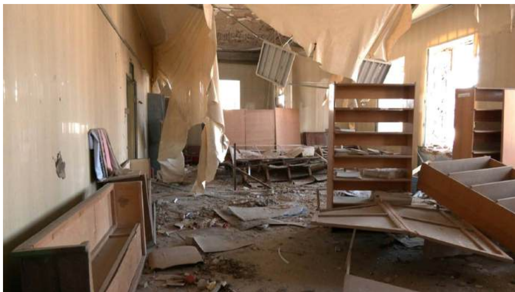
Il. 5. Budynek Rejonowego Muzeum Krajoznawczego w Orchiwie, uszkodzony w wyniku ostrzału rosyjskich wojsk. Fot.: Суспільне. Запоріжжя, 02.03.2024; https://suspilne.media/696968-zranenij-poskodzenij-ale-poki-so-stoit-akij-mae-viglad-kraeznavcij-muzej-u-prifrontovomu-orihovi-na-zaporizzi/ ; data odczytu: 15.03.2024.
