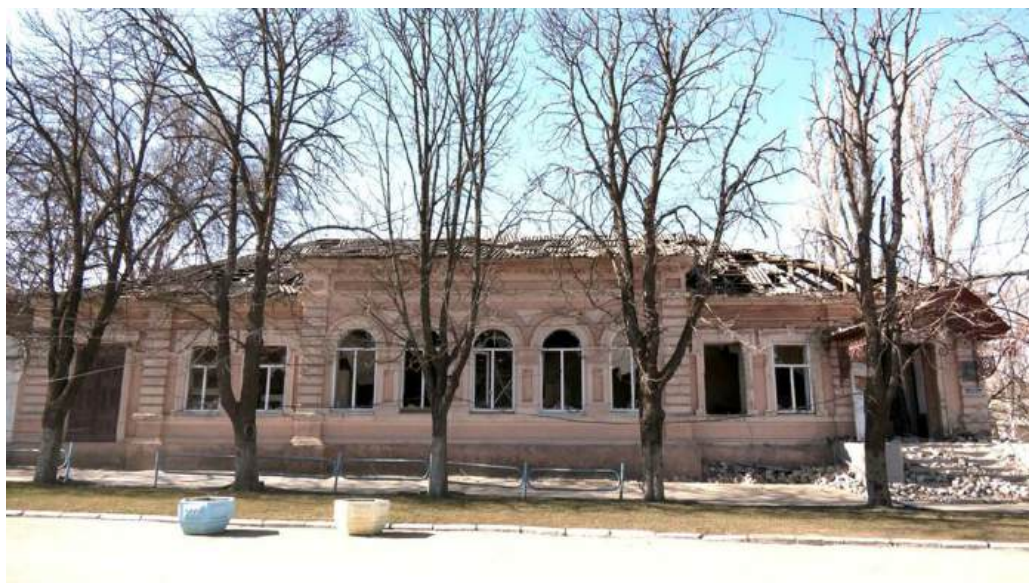
Il. 2. Budynek Rejonowego Muzeum Krajoznawczego w Orchowie uszkodzony w wyniku ostrzału rosyjskich wojsk. Fot.: Суспільне. Запоріжжя, 02.03.2024; https://suspilne.media/696968-zranenij-poskodzenij-ale-poki-so-stoit-akij-mae-viglad-kraeznavcij-muzej-u-prifrontovomu-orihovi-na-zaporizzi/ ; data odczytu: 15.03.2024.
