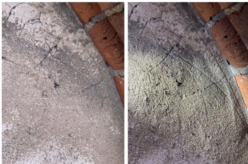
Il. 2. Szczyt prezbiterium; zwieńczenie jednej z blend w drugiej kondygnacji wieży środkowej podczas badań oraz inwentaryzacji rytów. Powierzchnia pierwotnego tynku obserwowana w świetle dziennym i zagłębienia rytów maswerku oświetlone sztucznym światłem bocznym. Fot. J. Polak
