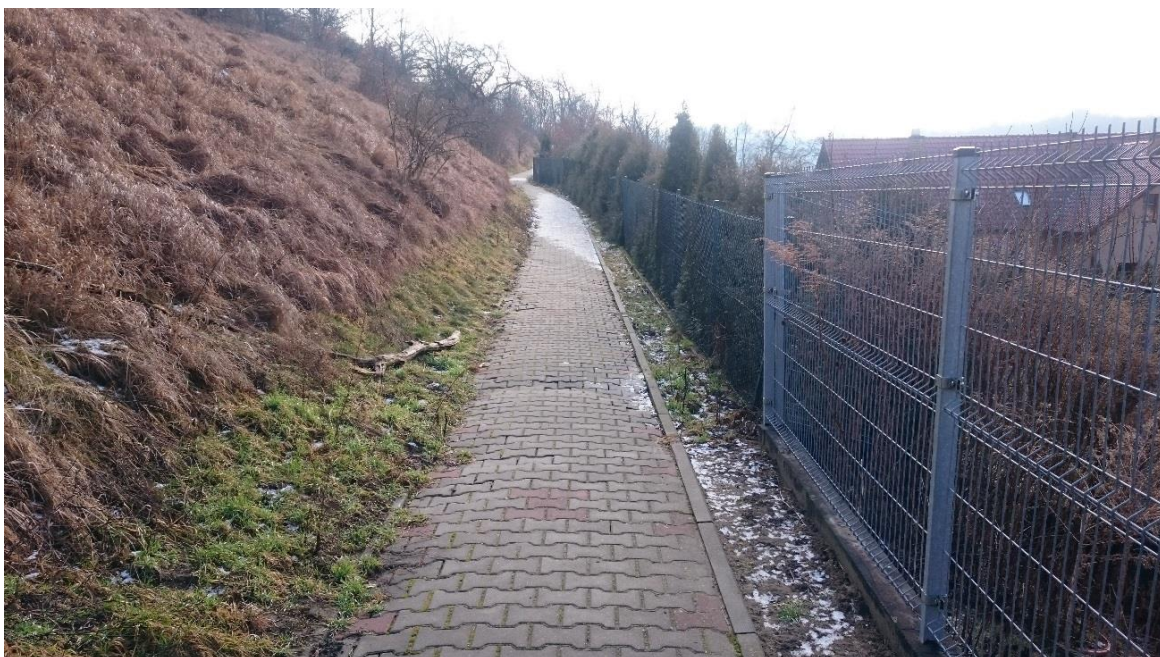
Fot. 1. Odkształcony profil chodnika prowadzącego do ścieżki na Winnej Górze.
