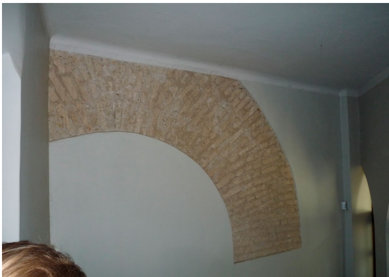
Il. 10. Wilno, kościół trynitański. Łuk odciążający nad arkadą niszy ołtarzowej w nawie widoczny do strony klatki schodowej w klasztorze, przy zakrystii, 2018. Fot. K. Guttmejer
