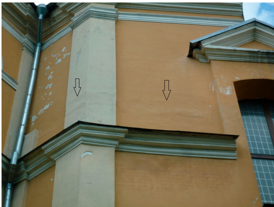
Il. 17. Wilno, kościół trynitański. Narożnik elewacji wschodniej nawy, w kierunku do wieży, 2018. Fot. K. Guttmejer Strzałkami zaznaczono ślad gzymsu attyki, skutego w trakcie nadbudowy „tamburu” (por. il. 18)
