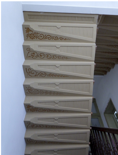
9. Fragment klatki schodowej, betonowe podniebienie schodów, stan w trakcie remontu. Fot. J. Kucharzewska, 2018
