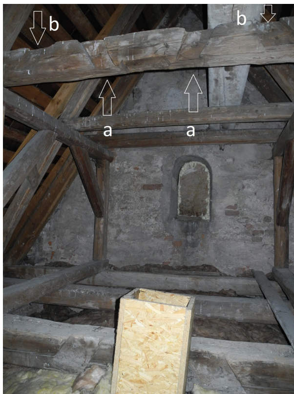
4. Kościół w zespole klasztorным Karczówka (Kielce). Widok na trzeci wiązar prezbiterium od strony odwiązania. Na jętce zachowane gniazda po złączach. Oznaczenia: a – ślad po przekładce zastrzałów podwieszających storczyk; b – ślad po nakładkach zastrzałów krzyżujących się z wyżej wymienionymi (fot. M. Prarat, 2017).
