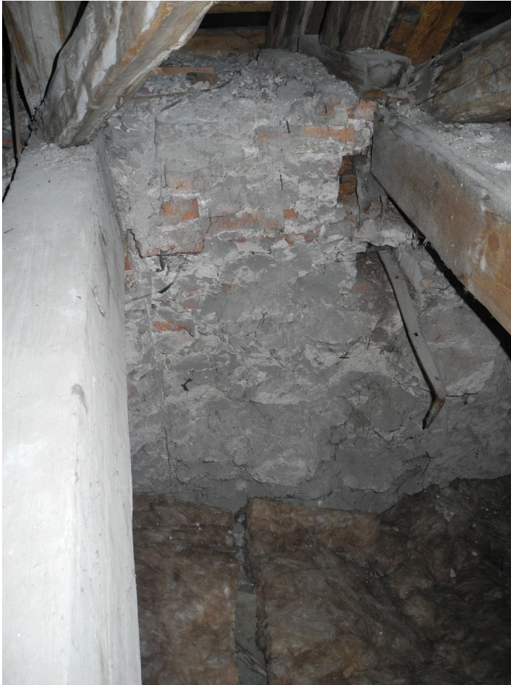
9. Kościół w zespole klasztornym Karczówka (Kielce). Mur ściany północnej nawy. Pomiędzy więzarami nr 11 i 12 widoczna rozkuta struktura pierwotnej elewacji wschodniej (fot. M. Prarat, 2017).
