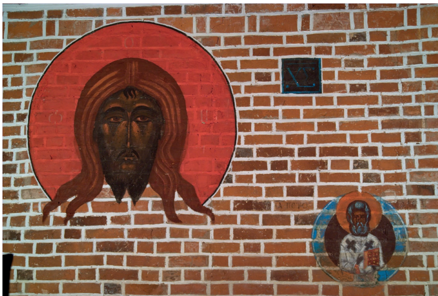
Fot. 5. Górowo Haweckie, cerkiew pw. Podwyższenia Krzyża Świętego. Polichromie na ścianie wschodniej prezbiterium – Chrystus w typie Mandylionu i św. Piotr. Fot. Adam Cupa
