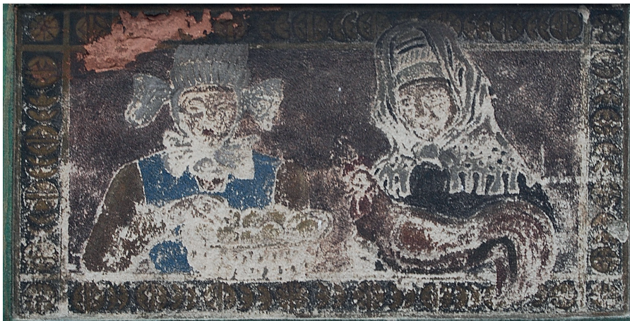
Fot. 6. Gdańsk, kamienica przy ul. Długiej 1. Fasada, malowidło nad prawym oknem parteru – wygląd przed przystąpieniem do prac w 2015 r. Fot. Anna Żychska
