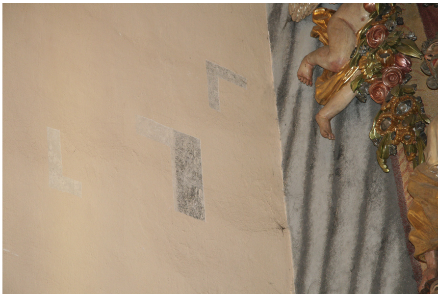
3. Dzierzgoń, kościół pw. Trójcy Przenajświętszej. Północna ściana prezbiterium. Wykonane odkrywki jednoznacznie pokazują, że malowana kotara, stanowiąca tło ołtarza głównego, zachodzi na ściany boczne. Fot. K. Szczepińska
