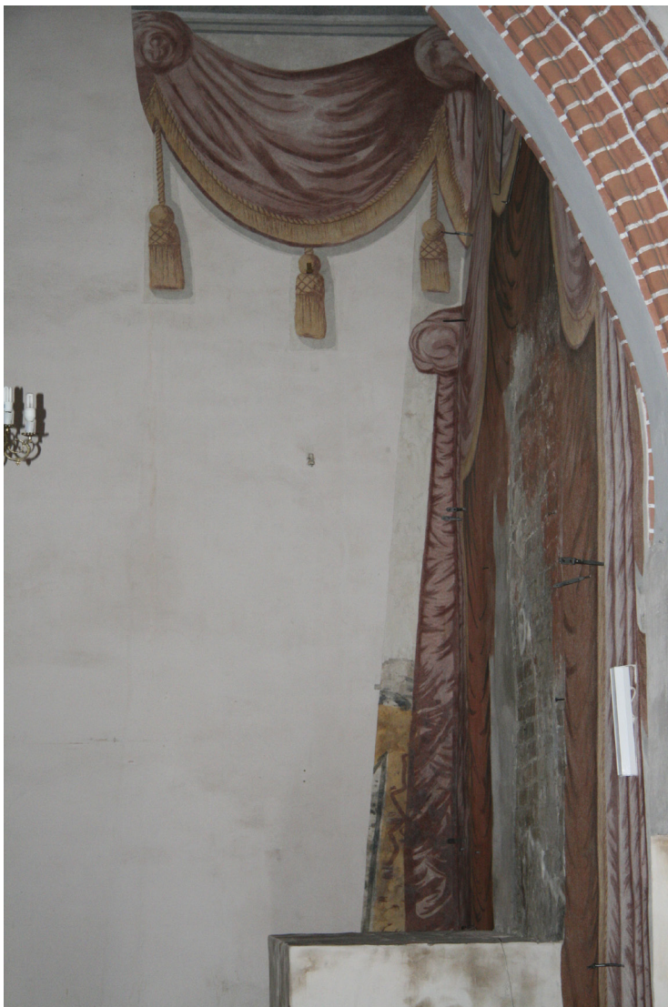
9. Dzierzgoń, kościół pw. Trójcy Przenajświętszej. Północno-wschodni narożnik kościoła. Kotara ze ściany tęczowej przechodzi na ścianę północną. U góry, pod stropem, ucięta forma jednoznacznie wskazuje na kontynuację malowidła. U dołu widoczny fragment dolnego pasa dekoracji, obecnie trudny do zinterpretowania. Zdjęcie wykonane po zakończeniu prac przy malowidle, przed montażem ołtarza. Fot. K. Szczepińska
