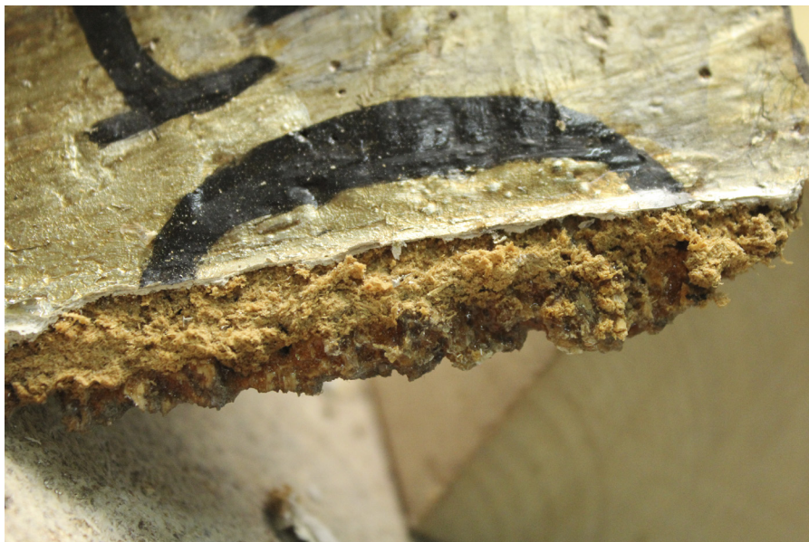
6. Dzierzgoń, kościół pw. Trójcy Przenajświętszej. Ołtarz północny. Miejsce pęknięcia szarfy z napisem GLORIA IN EXCELSIS DEO . Widoczna na zdjęciu żywica to kalafonia, której roztworem w trakcie wcześniejszych prac impregnowano drewno. Fot. K. Szczepińska
