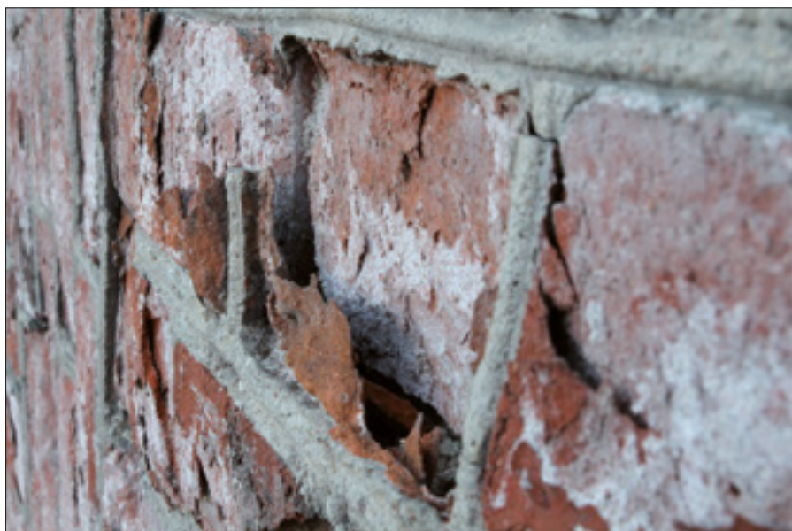
Fot. 2. Silna dezintegracja muru ceglany w wyniku działania soli (fot. K. Witkowska)
