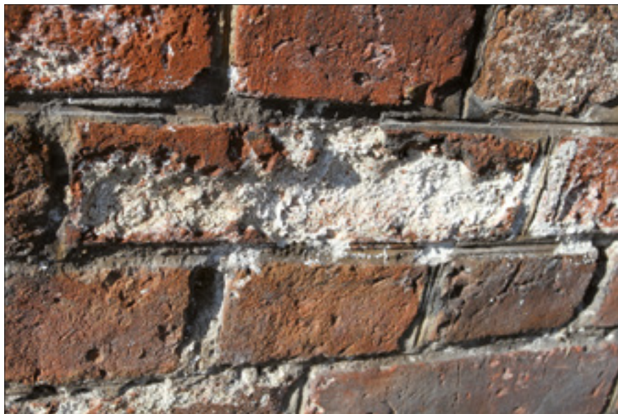
Fot. 1. Wykwity solne na murze ceglany. (fot. K. Witkowska)
