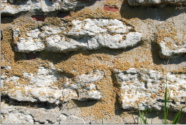
Fot. 9. Pomarańczowożółte porosty na zaprawie i kamieniu (fot. J. Karbowska-Berent)
