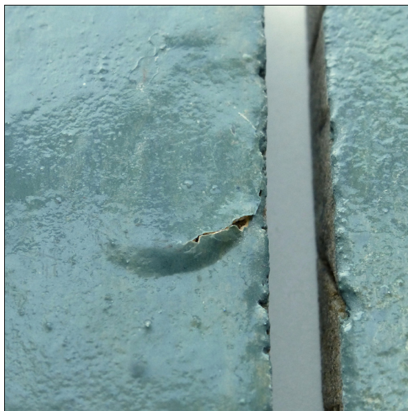
Fot. 8. Spęcherzenie warstwy malarskiej z gruntem (pr. 2). Fot. M. Rudy
