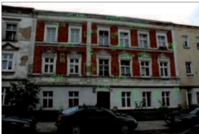
Il. 1. Widok elewacji frontowej zabytkowego budynku przy ul. Żeromskiego 39 w Olsztynie z zaznaczeniem miejsc wykonania badań (fot. E. Doleżyńska-Sewerniak)
