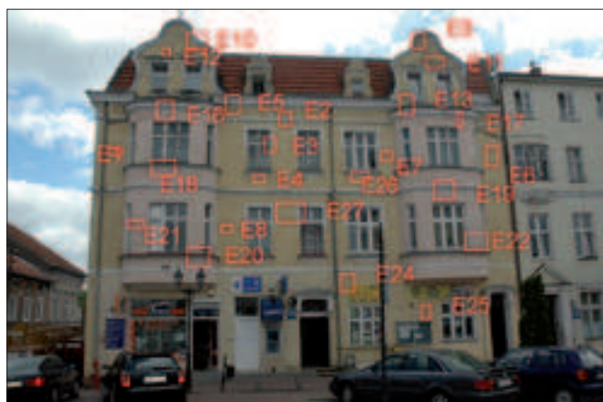
Il. 10. Widok elewacji frontowej zabytkowego budynku przy pl. Ratuszowym 14 w Górowie Iławeckim z zaznaczeniem miejsc wykonania badań (fot. E. Doleżyńska-Sewerniak)
