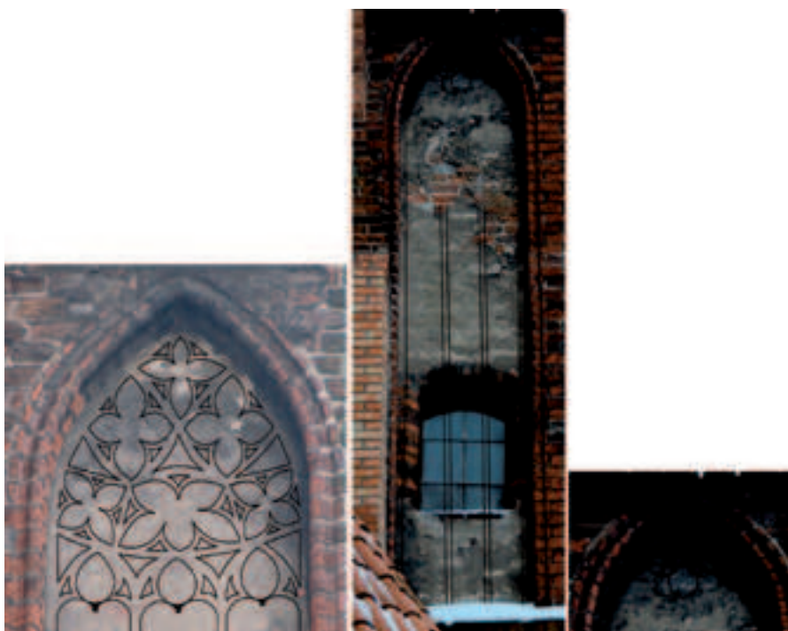
Il. 14. Pierwsza i druga od pn. blenda zakrystii kościoła NMPanny w Toruniu wraz z propozycją rekonstrukcji rysunku maswerku
