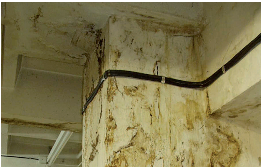
Il. 1. Zacieki w Magazynie Dubletów położonym pod patio (fot. K. Zykubek)
