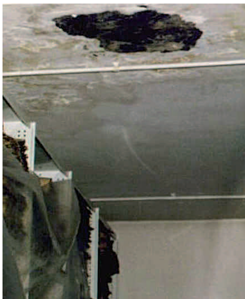
Il. 2. Zacieki, białe wysolenia i czarne plamy kolonii grzybowych na suficie na I piętrze AP (mag. XXV) (fot. K. Zykubek)
