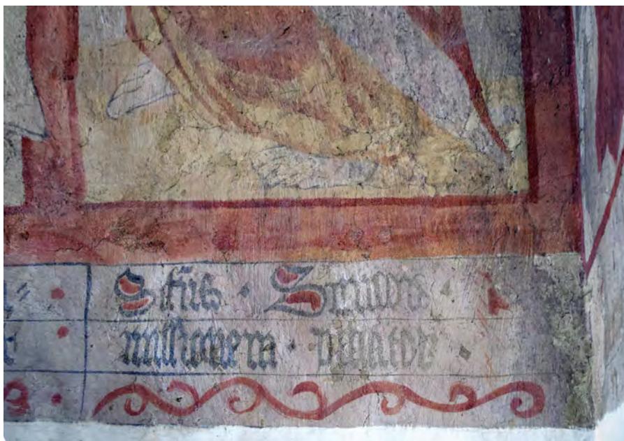
Il. 7. Morąg, kościół św. Apostołów Piotra i Pawła. Prezbiterium, malowidło Kolegium Apostołów, pas inskrypcyjny pod postacią św. Szymona Gorliwego z widocznymi śladami zawilgocenia warstwy malarskiej. Fot. J. Małek
