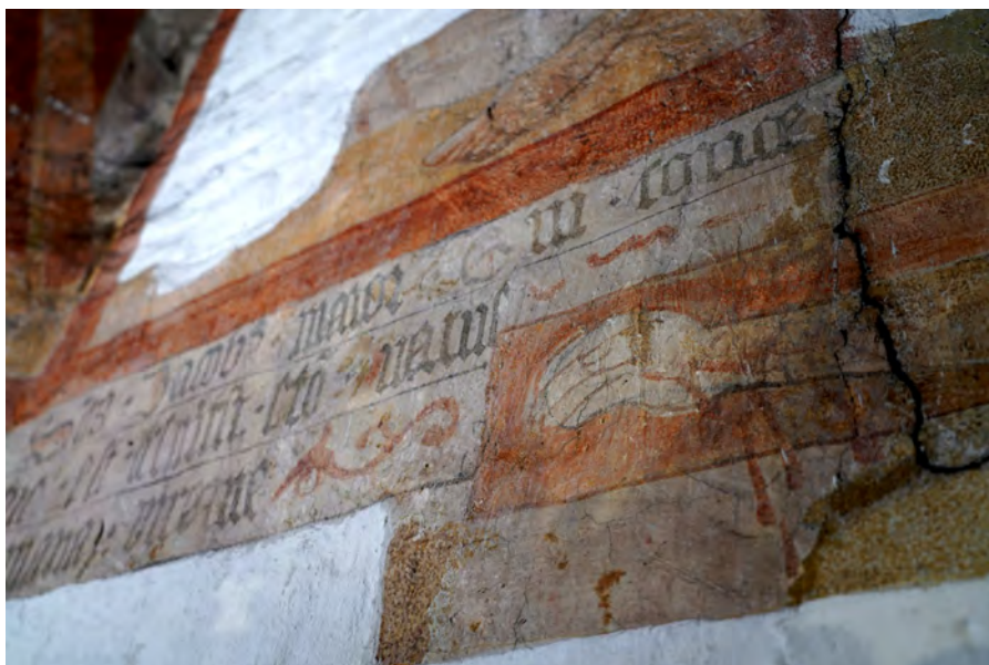
Il. 5. Morąg, kościół św. Apostołów Piotra i Pawła. Prezbiterium, fragment ściany wschodniej: relikw grupy Ukrzyżowania i pas inskrypcyjny, widoczne ślady pęknięcia ściany. Fot. J. Małek
