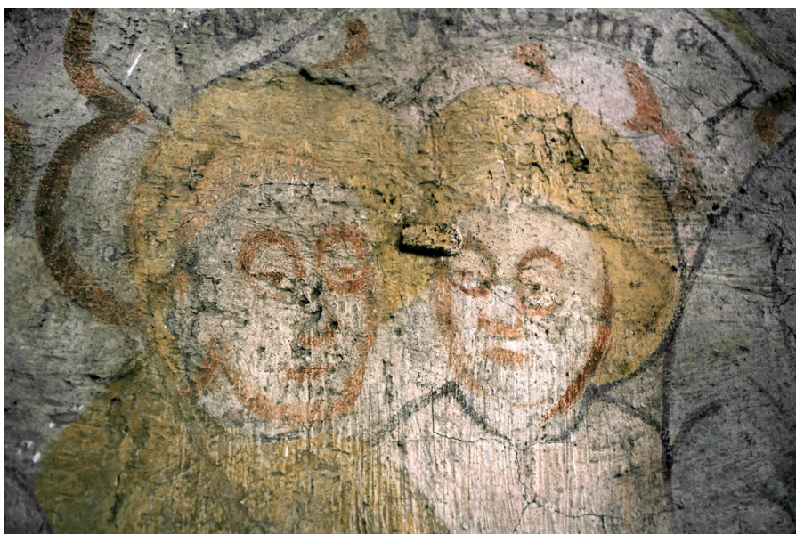
6. Morąg, kościół św. Apostołów Piotra i Pawła. Prezbiterium, fragment ściany północnej: malowidło Wielka Rodzina Marii (detal), widoczne ślady uszkodzenia mechanicznego przez gwoździe. Fot. J. Małek
