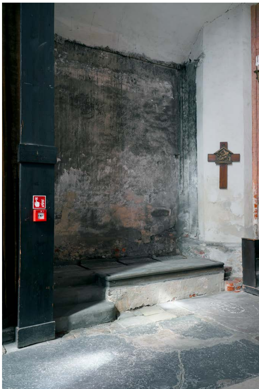
Il. 26. Toruń, kościół WNMP, ściana zachodnia, przestrzeń między portalem a półfilarem narożnym po stronie północnej po demontażu stall i przedpiersi. Fot. J. Raczkowski
