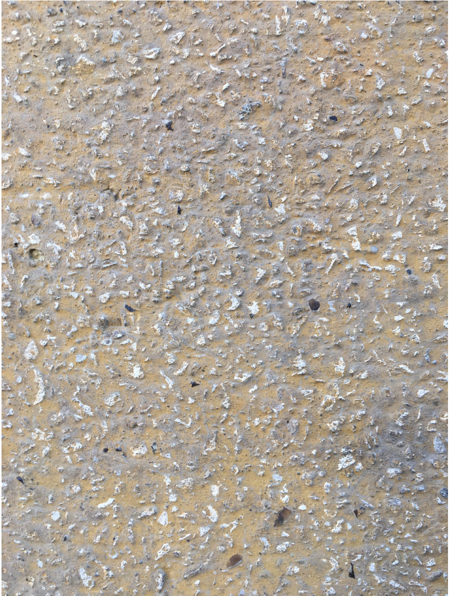
Il. 3. Gdańsk, budynek Związku Gospodarczego Miast Morskich, fragment elewacji bocznej od strony ul. Bielańskiej – tynk zmywany ze strefy cokołowej. Fot. W. Stasińska
