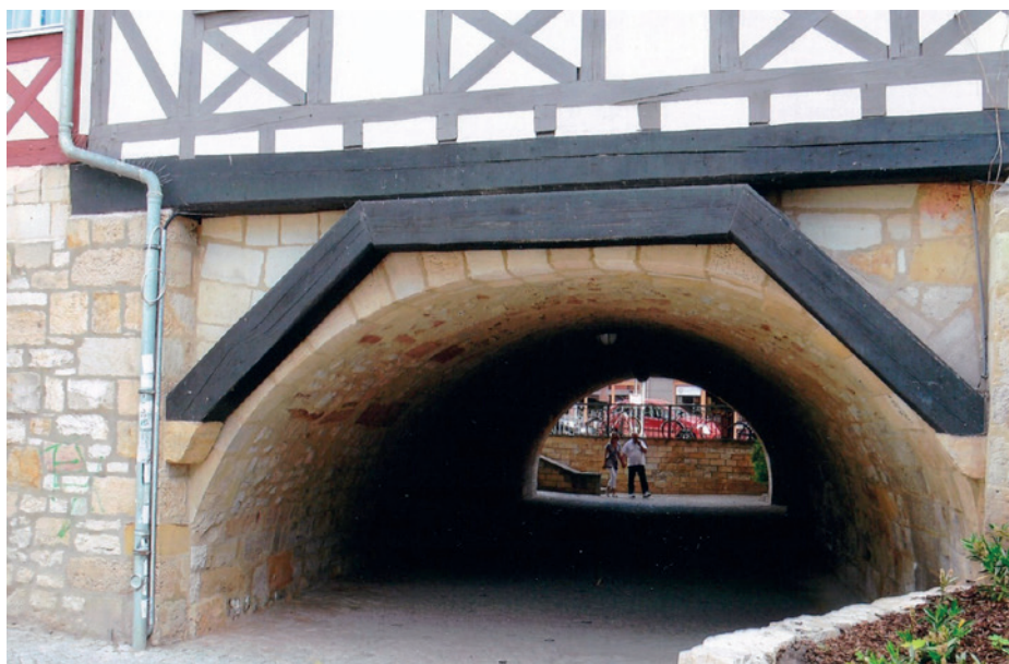
Ryc. 22. Erfurt, Krämerbrücke. Drewniane, poziome i ukośne, zastrzałowe konstrukcje wewnętrznych partii murów domostw, zainstalowane dla przesunięcia ich ścian i powiększenia powierzchni użytkowej (fot. G. Wilke)
