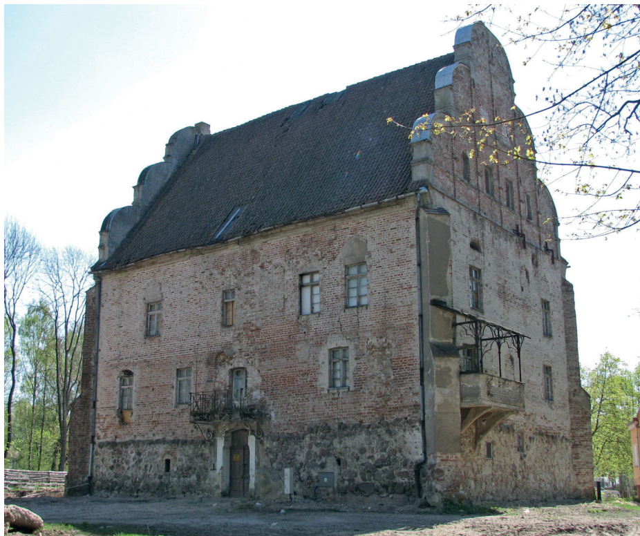
Ryc. 4. Giżycko, pow. loco. Dom wieżowy. Stan sprzed remontu (fot. B. Wasik)
