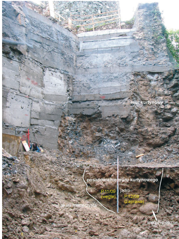
Ryc. 14. Wleń. Zamek górny – urwisko po osunięciu się zbocza z murem obronnym i zabezpieczeniu płaszczem betonowym. Na profilu widoczny poziom posadowienia drugiego muru i jego wyższa partia gotycka. Zaznaczono lokalizację prób laboratoryjnych (wg Jaworski 2009)
