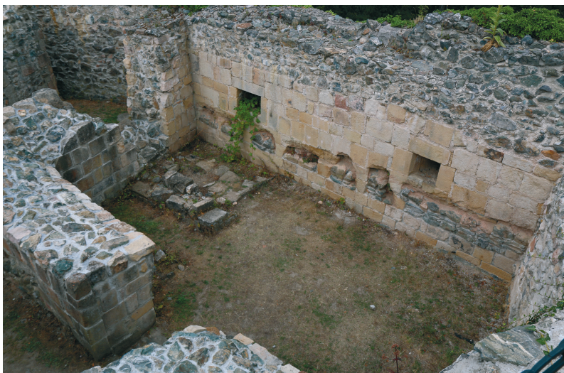
Ryc. 8. Wleń. Dolna kondygnacja romańskiego palatium (pomieszczenie 5) na górnym zamku. U dołu, po lewej stronie widoczne wejście do przyziemia, w ciosowej okładzinie na wprost – dwa otwory okienne, w narożniku poniżej jednego z nich – relikty pieca typu hypokaustum, powstałego już w innej fazie (fot. M. Chorowska)
