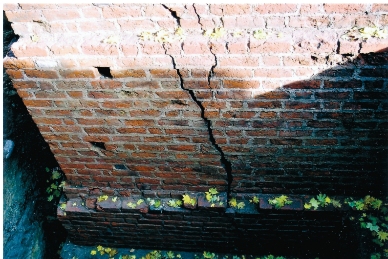
Ryc. 12. Pozostałości wieży zamku w Poznaniu (zniszczone w latach 2011–2013) (fot. T. Ratajczak)
